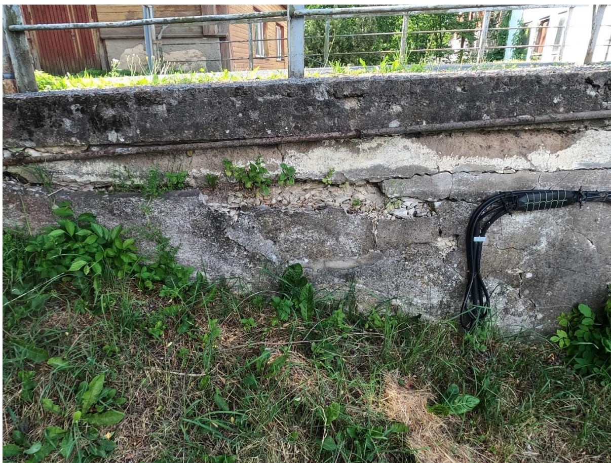
Foto 7 Silla külgseina pealmine kahjustus
